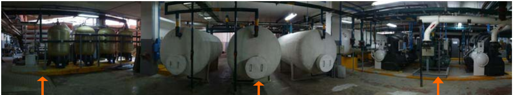
Planta de Osmosis Inversa
