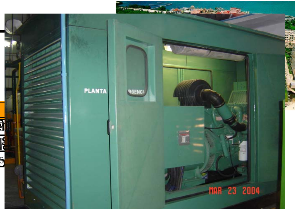
Generador con Caseta Acústica PLANTA DE AUTOGENERACIÓN
